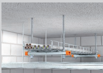
Jednoslojna plafonska montaža iznad visećeg protivpožarnog plafona.
